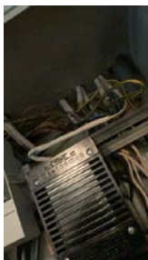
Lysglimt i forbindelse med gjennomføringer i sikringsskap
