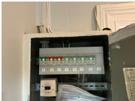
Automatsikringer i sikringsskap plassert i entré.
