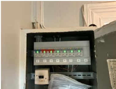
Automatsikringer i sikringsskap plassert i entré.
