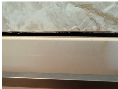
Fuktutsvelling på underside av benkeplate v/ oppvaskmaskin. Må anses å være normal slitasje.
