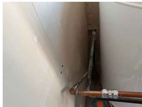
Irr på kobber rør i bod.
