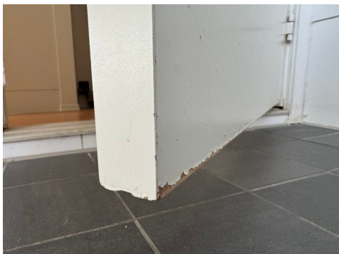
Fuktutsvelling/slitasje i nedre del av badedør.
