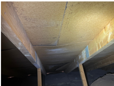
Misfarging i sutak.
