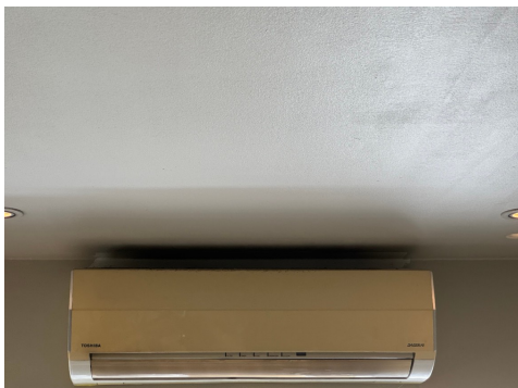
Varmepumpe med uttak i stue/kjøkken.
