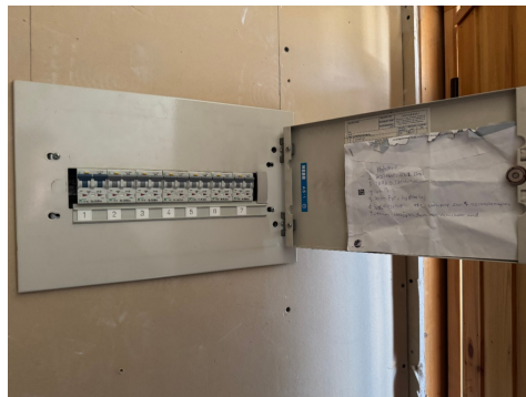
Sikringsskap i bod.
