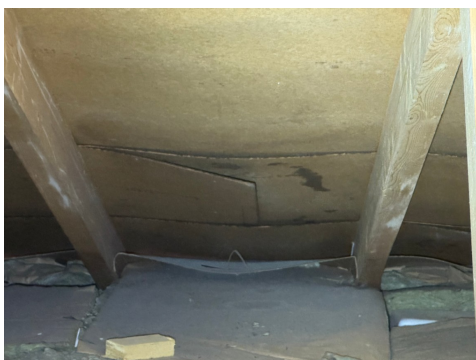
Liten luftespalte mellom isolasjon - sutak.
