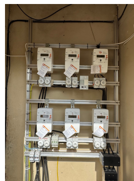
Felles sikringsskap med utvendig adkomst.
