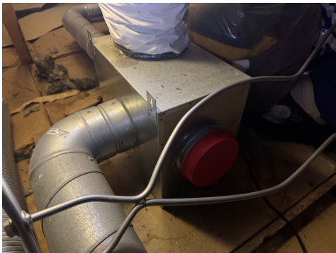
Ventilasjonsaggregat på koffertloft.
