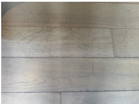
Slitasje/striper i parkettgulv.
