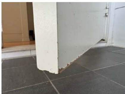
Fuktutsvelling/slitasje i nedre del av badedør.
