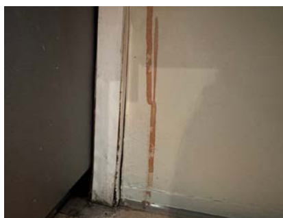
Fuktutsvelling i nedre del av sideplate v/ kjøleskap. Ingen forhøyede fuktverdier ble registrert i det aktuelle område.
