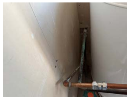
Irr på kobber rør i bod.
