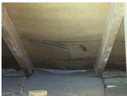
Liten luftespalte mellom isolasjon - sutak.
