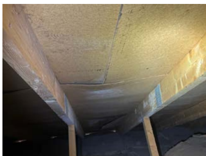
Misfarging i sutak.
