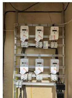
Felles sikringsskap med utvendig adkomst.
