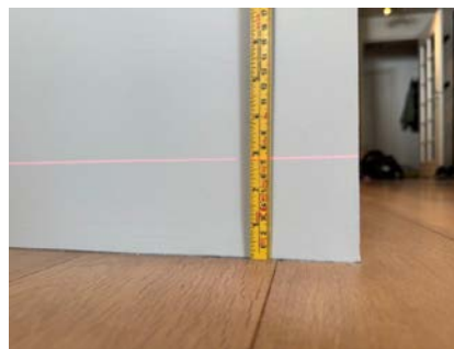
Bilder viser skjevheter i gulv i stue/kjøkken.
