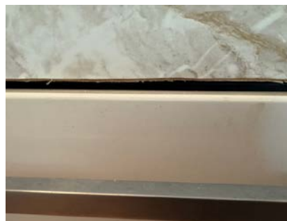
Fuktutsvelling på underside av benkeplate v/ oppvaskmaskin. Må anses å være normal slitasje.
