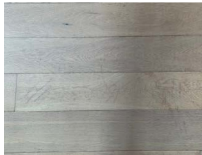
Slitasje/striper i parkettgulv.
