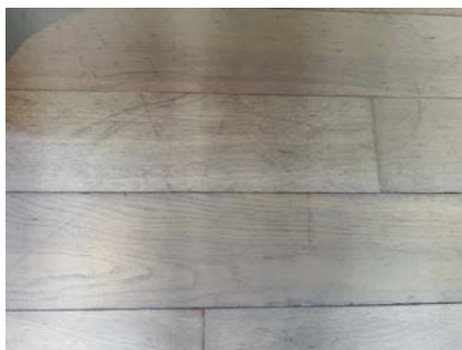
Slitasje/striper i parkettgulv.
