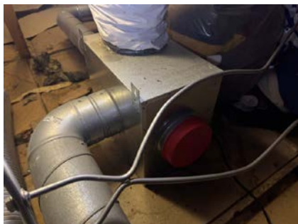
Ventilasjonsaggregat på koffertloft.
