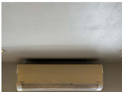
Varmepumpe med uttak i stue/kjøkken.
