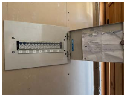
Sikringsskap i bod.
