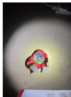
Det mangler lokk på boks på koffertloft. Lokk bør monteres.
