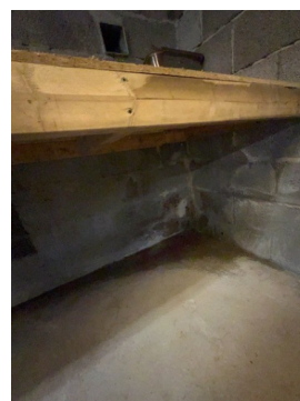
Fuktgjennomgang i grunnmur/gulv
