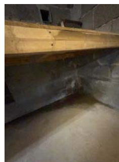
Fuktgjennomgang i grunnmur/gulv
