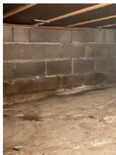
Fuktgjennomgang i krypkjeller.
