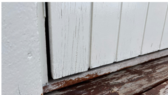
Balkongdøren er værslitt på nedre del
