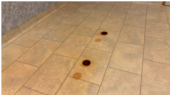
Merker på gulvet hvor vaskemaskinen har vært plassert
