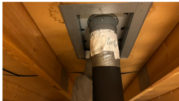
Fuktskjolder ved gjennomføringer i taket
