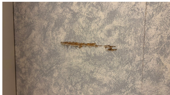
Skader på veggen hvor vaskemaskinen har stått
