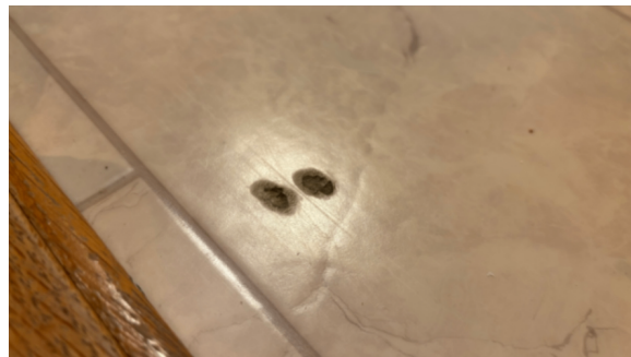
Skader på gulvet like ved døren
