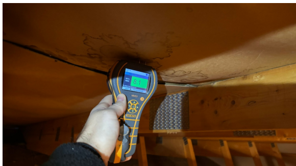
Fuktskjolder enkelte steder, men fuktsøk viser ingen tegn til unormale verdier
