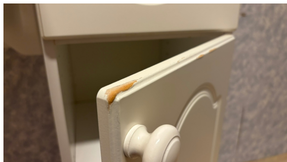
Noe slitasje på innredningen
