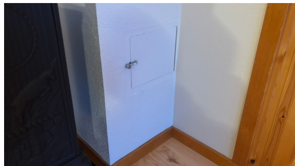
Det mangler ildfast plate på gulvet under sotluken
