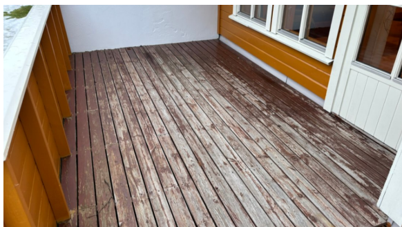
Terrassedekke er værslitt
