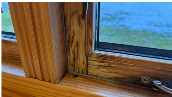
Fuktmerker på vinduet
