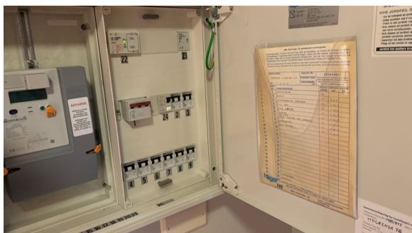
Sikringsskapet er plassert i gangen
