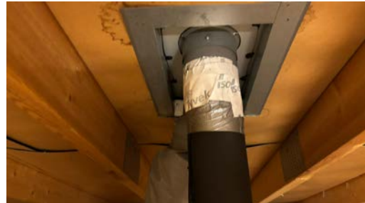
Fuktskjolder ved gjennomføringer i taket
