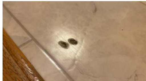
Skader på gulvet like ved døren
