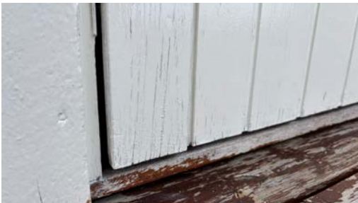
Balkongdøren er værslitt på nedre del
