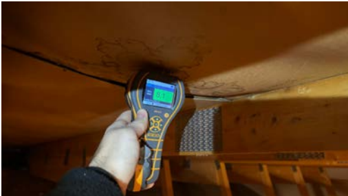
Fuktskjolder enkelte steder, men fuktsøk viser ingen tegn til unormale verdier
