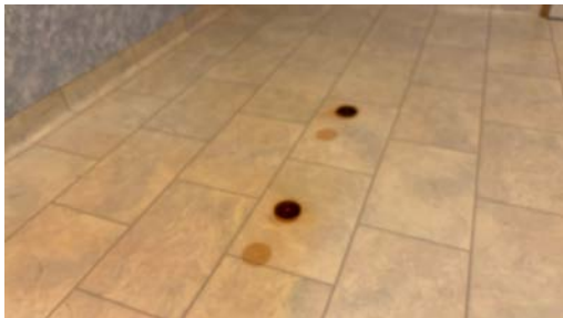
Merker på gulvet hvor vaskemaskinen har vært plassert
