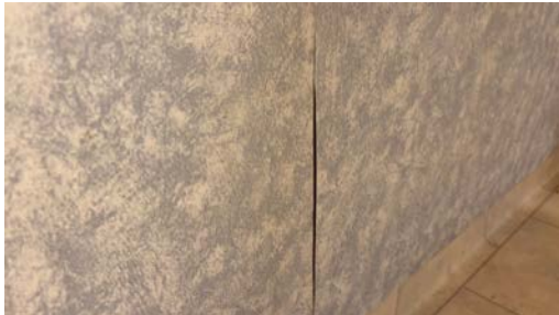
Åpninger i tapetskjøter
