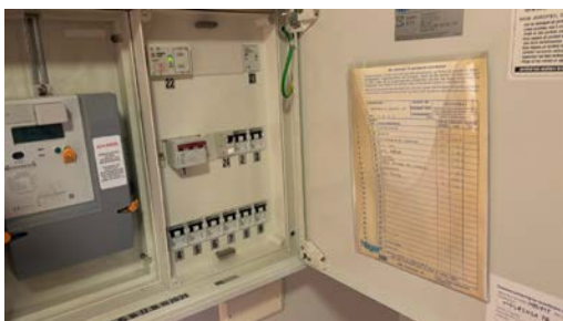
Sikringsskapet er plassert i gangen
