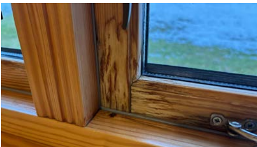
Fuktmerker på vinduet
