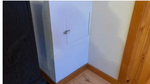
Det mangler ildfast plate på gulvet under sotluken
