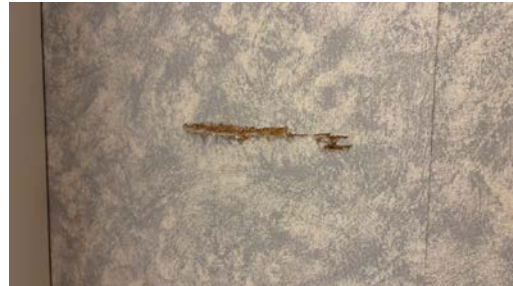
Skader på veggen hvor vaskemaskinen har stått
