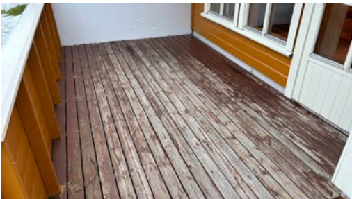
Terrassedekke er værslitt
