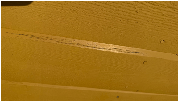
Eksempelbilde på noe malingsavflass på kledning.
