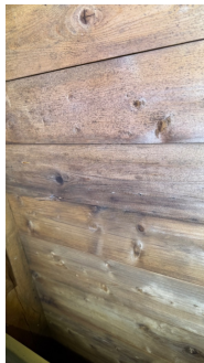
Eksempelbilde av misfarging i tretak.
