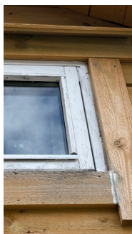
Eksempelbilde av slitasjegrad/ malingsavfluss.
