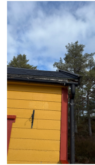
Eksempelbilde av manglende spillblikk mellom renner og taktekkning.
