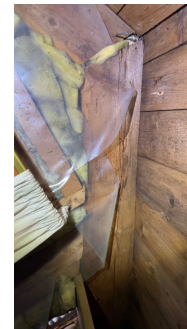
Eksempelbilde av utilstrekkelig dampsperre.
