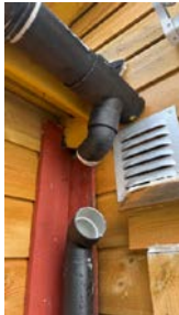
Eksempelbilde av manglende tilkobling.
