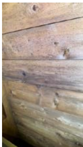
Eksempelbilde av misfarging i tretak.
