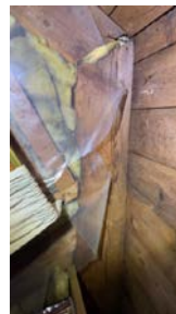
Eksempelbilde av utilstrekkelig dampsperre.
