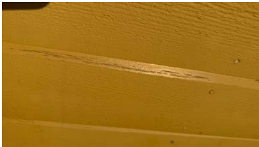
Eksempelbilde på noe malingsavfluss på kledning.
