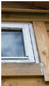
Eksempelbilde av slitasjegrad/ malingsavfluss.
