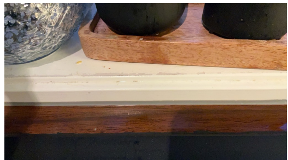
Overflateslitasje/skade på vindusforing
