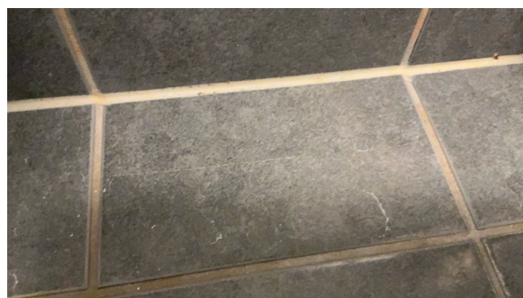
Sprekt flis i dusj, samt noe svertesopp
