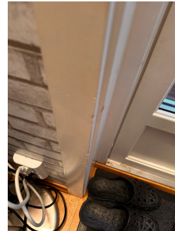
Slitasje på karm til balkongdøren
