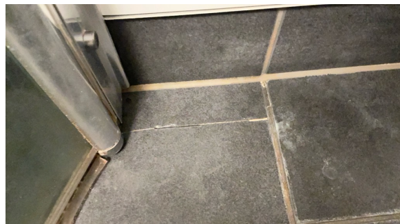
Sprekt flis i dusj, samt noe svertesopp
