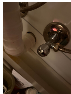
Manglende tetting rundt avløpsr
