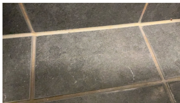
Sprekt flis i dusj, samt noe svertesopp
