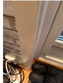
Slitasje på karm til balkongdøren
