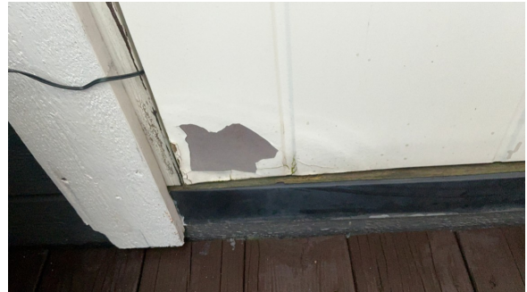
Svelling, malingsflass og slitasje på karm - bod 2.etg
