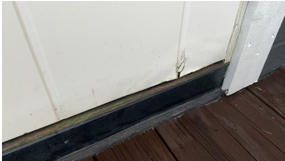
Svelling og slitasje på karm - bod 2.etg
