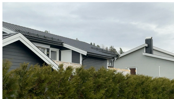
Mangler snøfanger over boden
