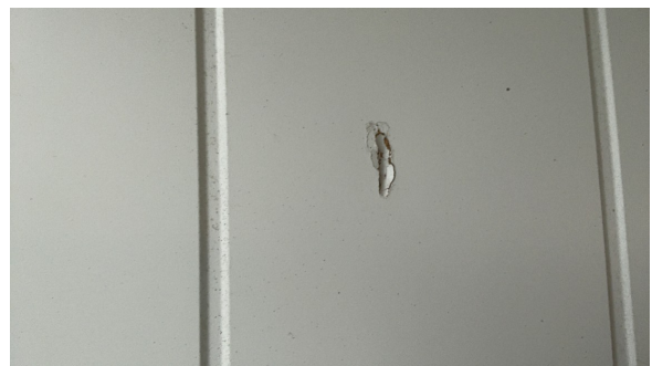
Skade på dørrblad bod 1.etg
