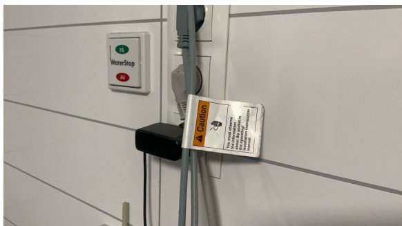
Tilkobling via stikkontakt
