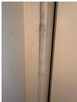
Slitasje på karm til balkongdøren
