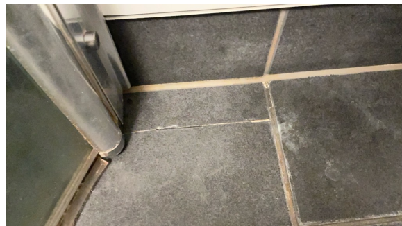
Sprekt flis i dusj, samt noe svertesopp
