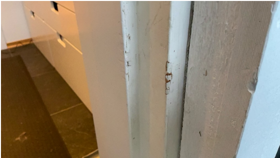
Oppskrapet karm på ytterdøren
