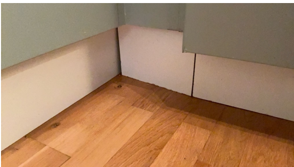
Skjev ende av sokkel
