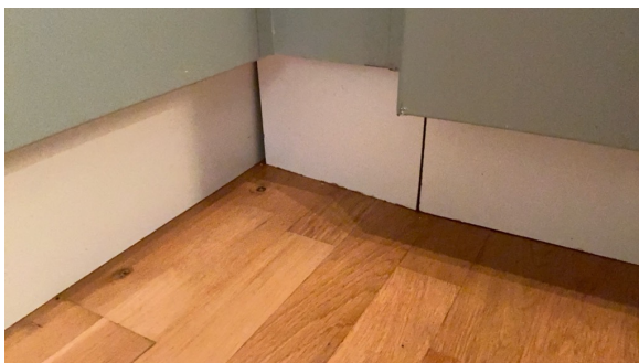
Skjev ende av sokkel
