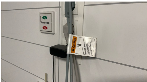
Tilkobling via stikkontakt
