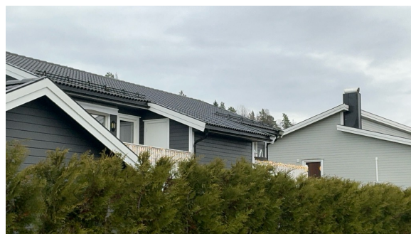
Mangler snøfanger over boden
