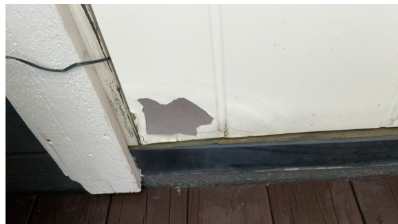
Svelling, malingsflass og slitasje på karm - bod 2.etg
