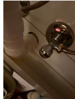
Manglende tetting rundt avløpsr
