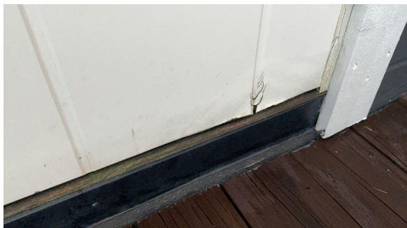
Svelling og slitasje på karm - bod 2.etg
