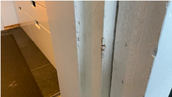
Oppskrapet karm på ytterdøren
