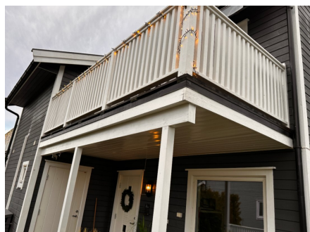
Mangler renne i forkant
