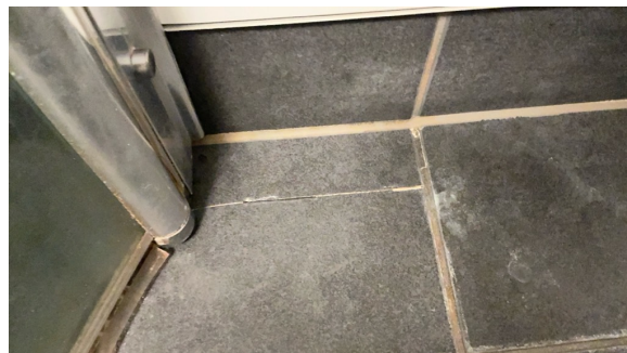
Sprekt flis i dusj, samt noe svertesopp
