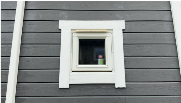
Det mangler vannbrett både over og under, samt beslag. Noe malingsflass registrert i bunn av vinduet
