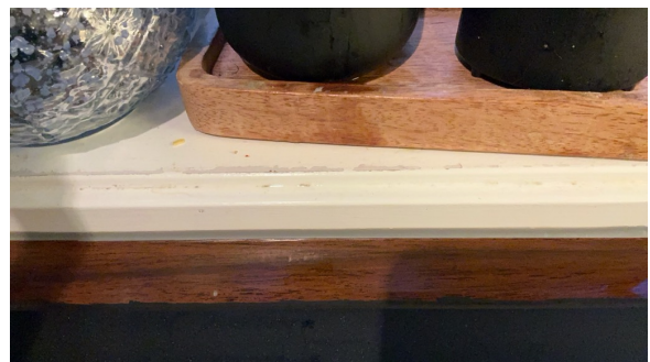
Overflateslitasje/skade på vindusforing
