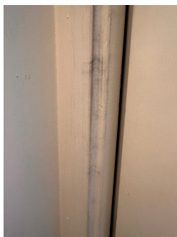
Slitasje på karm til balkongdøren
