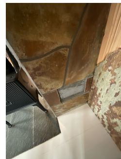
Mangler ildfast plate på gulv under sotluke.
