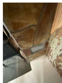
Mangler ildfast plate på gulv under sotluke.
