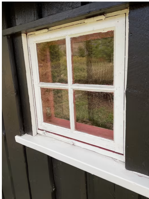
Værslitte karmen i eldre vinduer.
