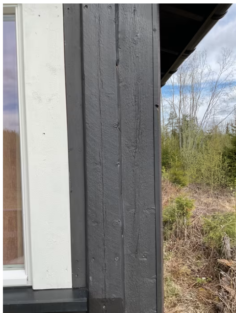
Sprekker i kledning.
