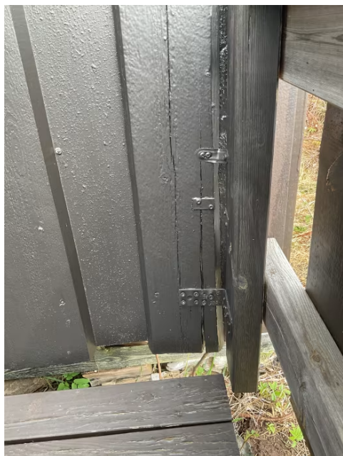
Sprekker i kledning.
