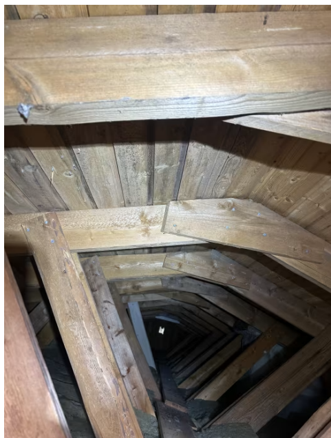
Svertesopp på undertak.
