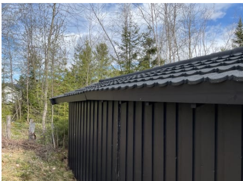
Skjevheter i konstruksjonen.
