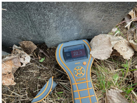
Fuktskader i kledning
