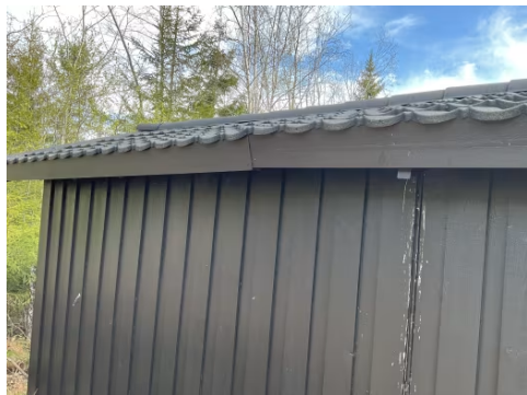
Manglende takrenner og nedløp.
