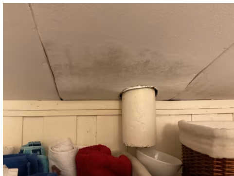
Fuktskade rundt lufting på bod/teknisk.
