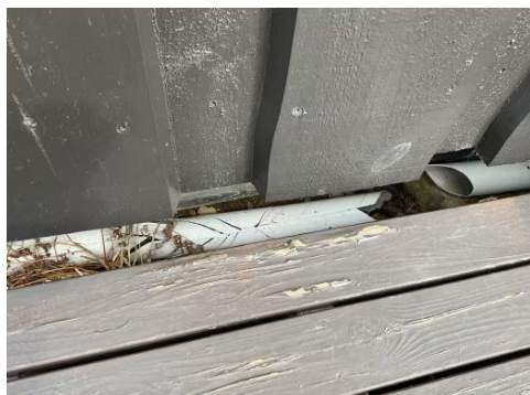
Ødelagt rør fra nedløp.
