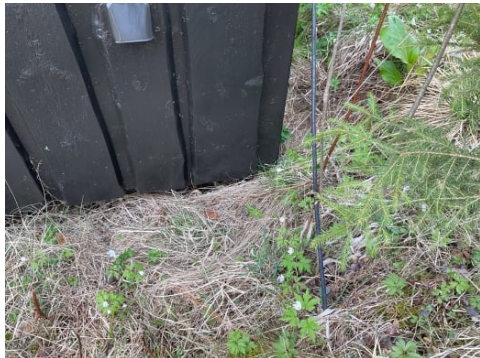
Ingen avstan mellom panel og terreng.
