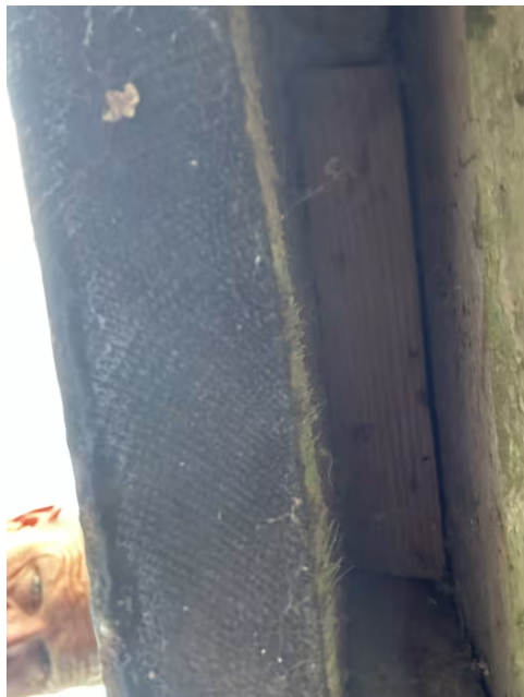
Liten lufting av kledning.
