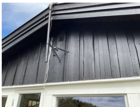
Sprekker i kledning.
