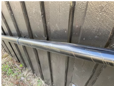
Frostspreng på nedløpsrør.
