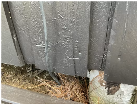
Sprekker i kledning.
