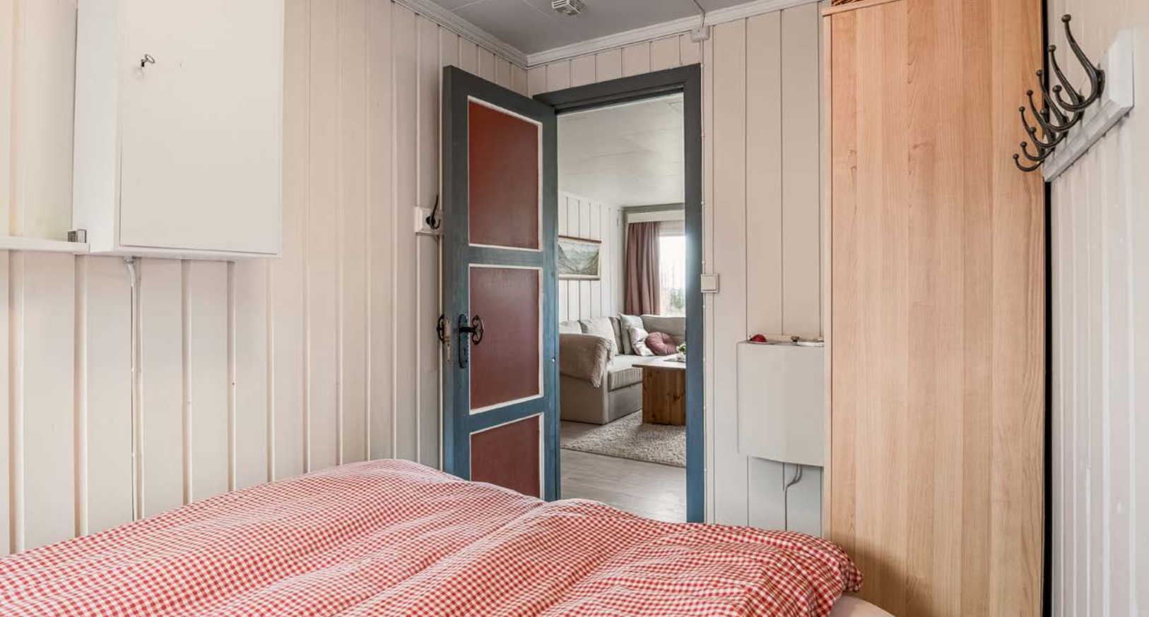
Sikringsskap med eldre skrusikringer montert på vegg.
