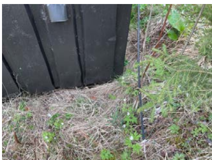
Ingen avstan mellom panel og terreng.
