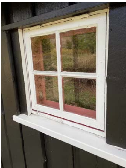
Værslitte karmen i eldre vinduer.
