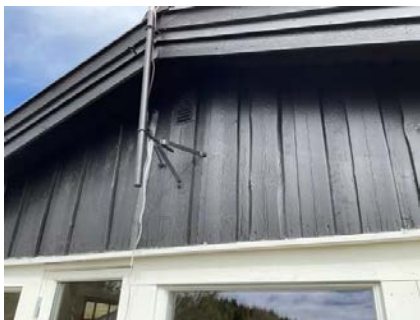
Sprekker i kledning.
