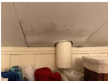
Fuktskade rundt lufting på bod/teknisk.
