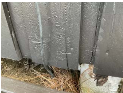
Sprekker i kledning.
