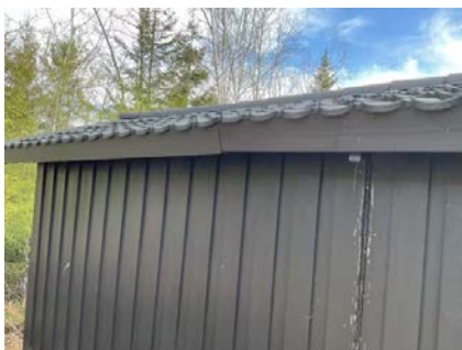
Manglende takrenner og nedløp.
