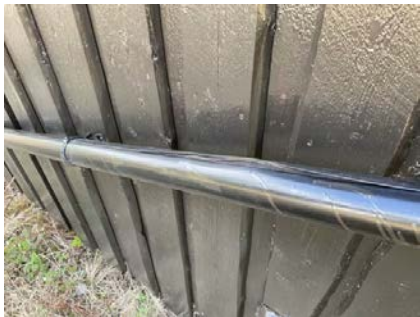
Frostspreg på nedløpsrør.
