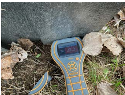
Fuktskader i kledning
