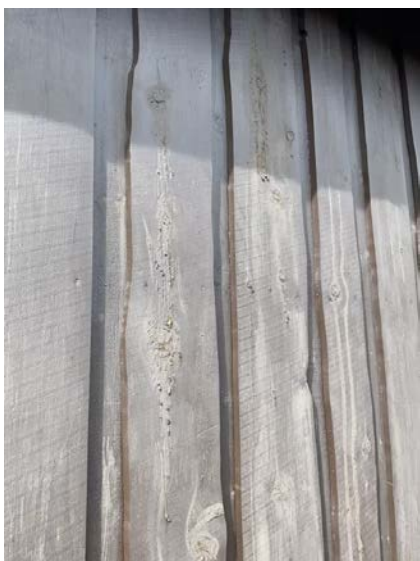
Utslag av kvæ
