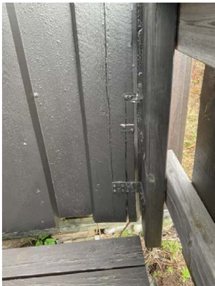
Sprekker i kledning.
