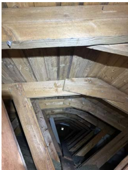
Svertesopp på undertak.
