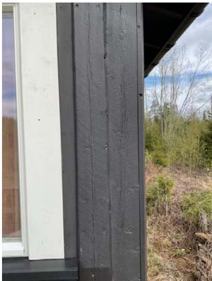
Sprekker i kledning.
