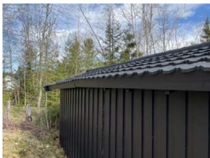
Skjevheter i konstruksjonen.
