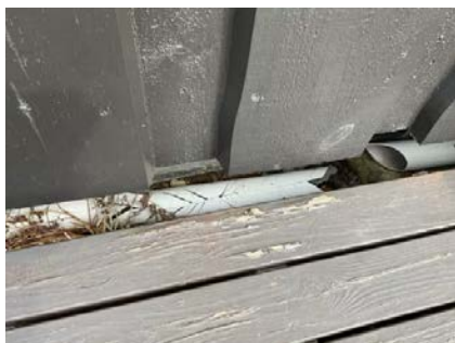
Ødelagt rør fra nedløp.
