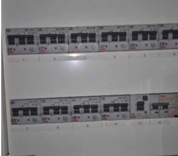
Bilde 1 Testknapp virker ikke på Kurs 4 og 10
