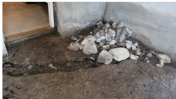
Eksempel på fuktpåkjenninger.
