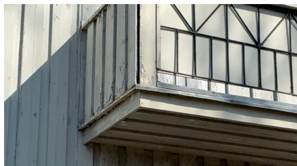
Eksempel på slitasje på overflater.
