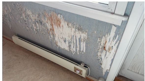
Eksempel på slitasje.
