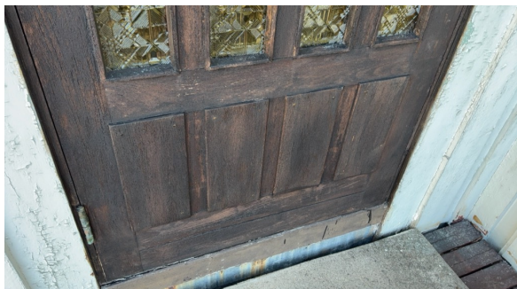
Slitasje på entredør.
