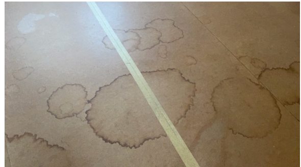
Enklere overflater på ett rom i 2. etasje, fuktmerker på gulv.
