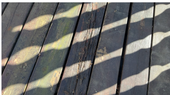
Eksempel på råte i gulvbord.
