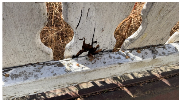
Eksempel på råte i rekkverkskledning.
