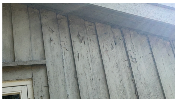
Eksempel på slitasje.
