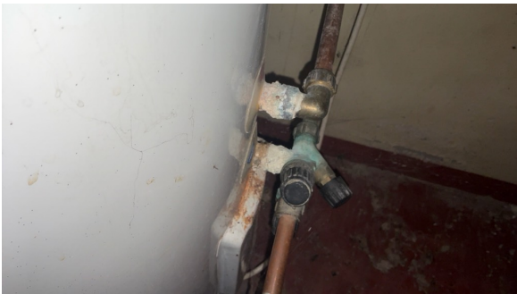
Eksempel på korrosjon på skjøt.
