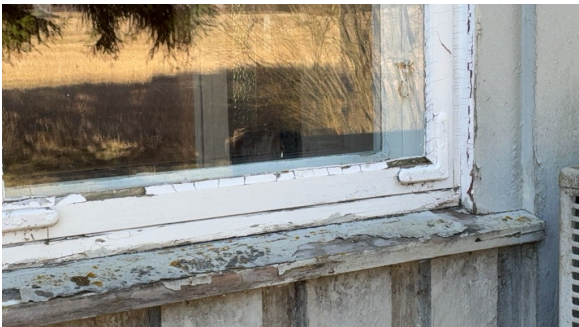
Eksempel på slitasje og avskaling av kitt.
