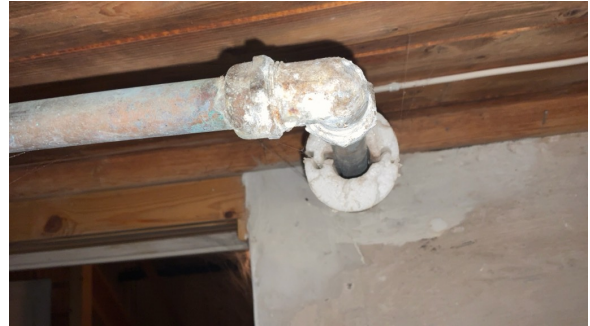
Drypplekkasje fra skjøt.
