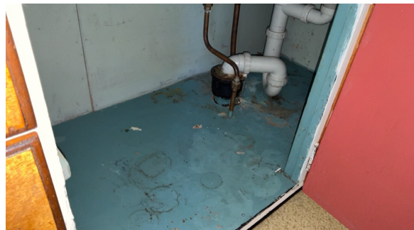
Eksempel på slitasje.
