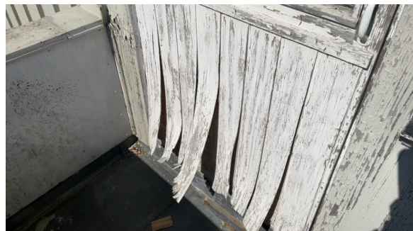
Slitasje og skade på balkongdør.
