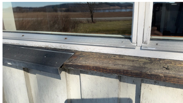
Det er varierende utførelse av beslag på vannbrett.
