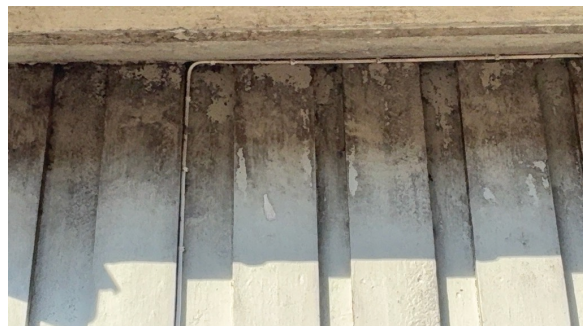
Eksempel på slitasje.
