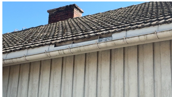
Det mangler forkantbeslag på ett sted.
