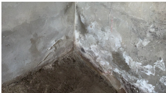
Eksempel på fuktpåkjenninger.
