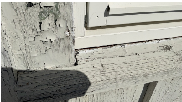
Eksempel på utetthet mellom vannbrett og vindu.
