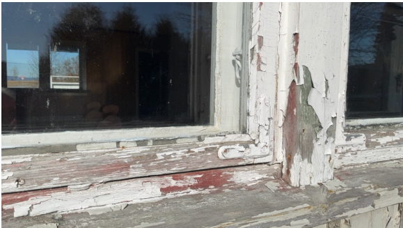
Eksempel på slitasje.
