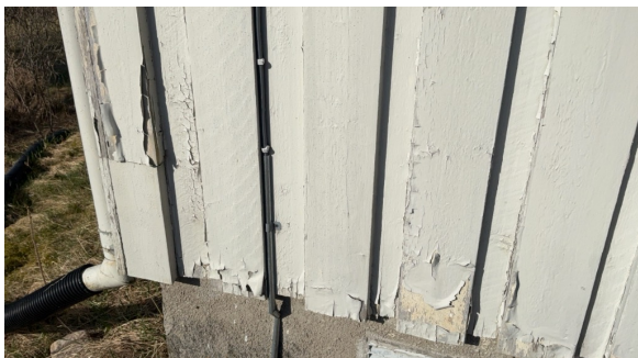
Eksempel på slitasje.
