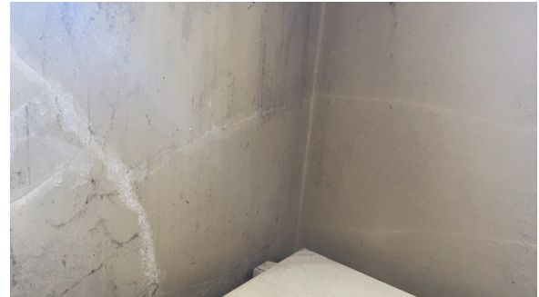
Eksempel på sprekker.
