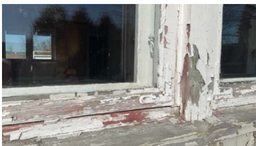
Eksempel på slitasje.
