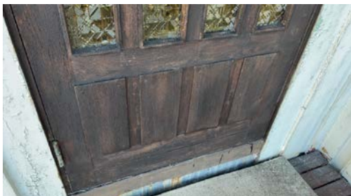
Slitasje på entredør.
