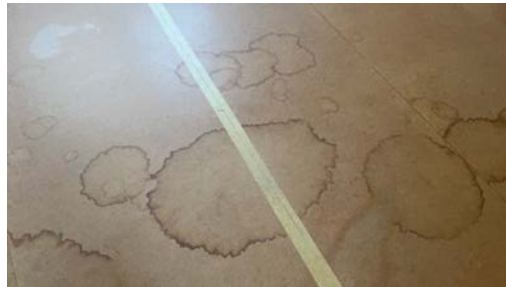
Enklere overflater på ett rom i 2. etasje, fuktmerker på gulv.
