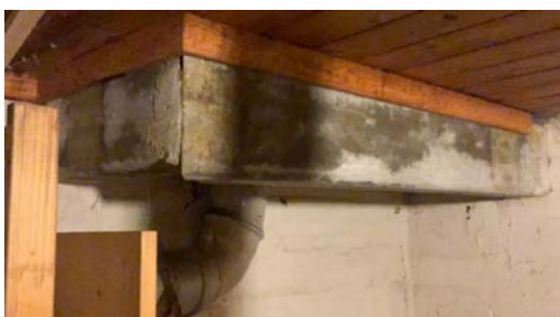
Ventilasjonsrør i kjeller av eternit.
