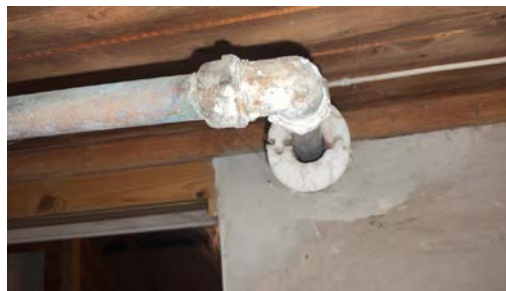
Drypplekkasje fra skjøt.
