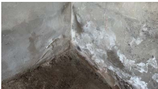
Eksempel på fuktpåkjenninger.
