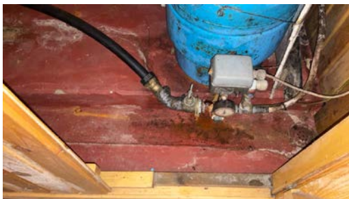
Vanninntak og stoppekran i kjeller.
