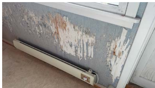
Eksempel på slitasje.
