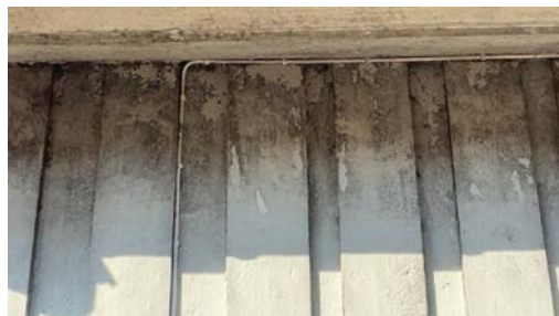
Eksempel på slitasje.
