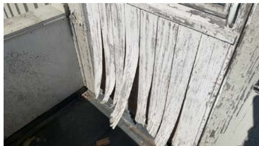
Slitasje og skade på balkongdør.
