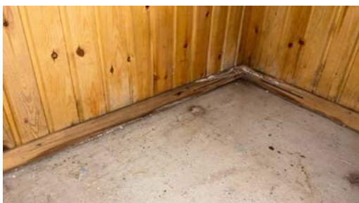
Eksempel på fuktpåkjenninger.
