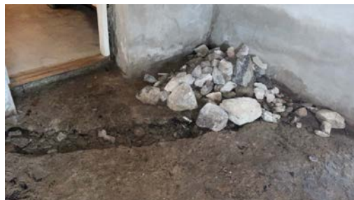
Eksempel på fuktpåkjenninger.
