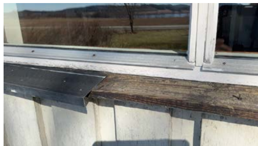
Det er varierende utførelse av beslag på vannbrett.
