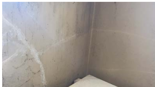
Eksempel på sprekker.
