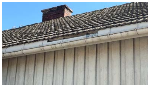
Det mangler forkantbeslag på et sted.
