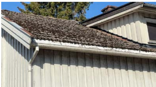
Eksempel på mosevekst.
