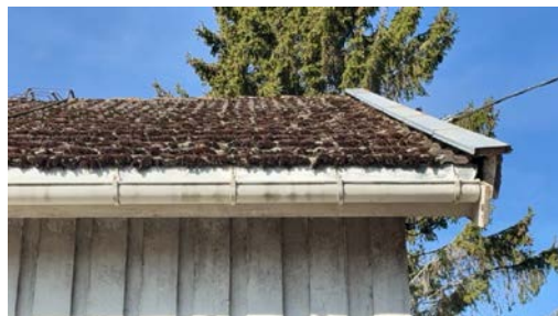
Eksempel på mosevekst.
