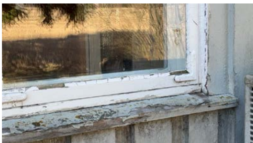
Eksempel på slitasje og avskaling av kitt.
