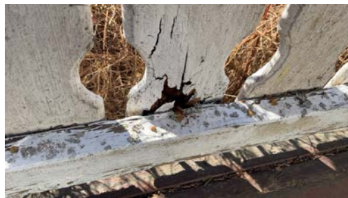
Eksempel på råte i rekkverkskledning.
