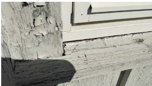
Eksempel på utetthet mellom vannbrett og vindu.
