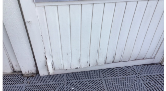
Balkongdør med fukt/råte skader i nedkant
