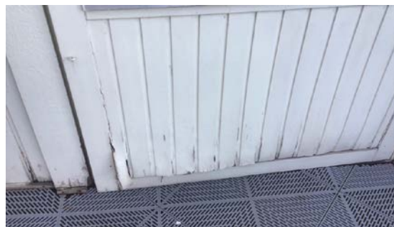
Balkongdør med fukt/råte skader i nedkant
