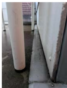
Manglende fall ut på beslaget mellom vegg og balkongdekke
