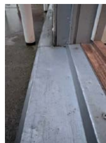
Manglende fall ut på beslaget under balkongdøren
