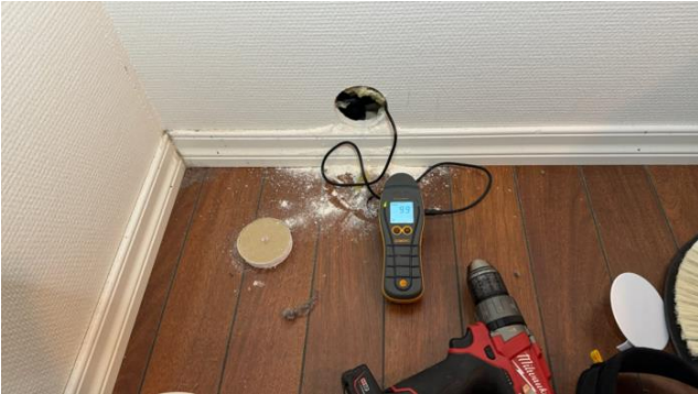
Bilde viser fuktmåling i vegg mot bad/dusjzone
