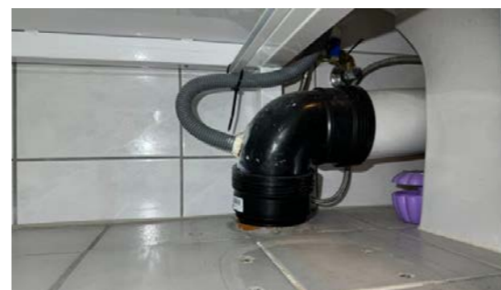
Bilde viser mangelfull fagmessig utførelse av røropplegg på bad
