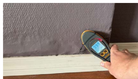
Bilde viser utslag på fuktindikator.
