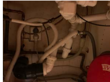
Røropplegget i kjøkken
