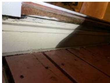
Ikke tilfredstillende overgang mellom beslag og terskel
