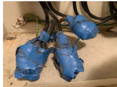
Forbledning av strøledninger må sjekkes elektriker
