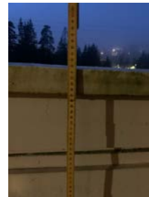
For lavt rekkverk iht dagens krav
