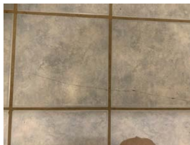
Sprekker i gulvfliser
