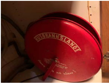
Brannslange i kjøkken
