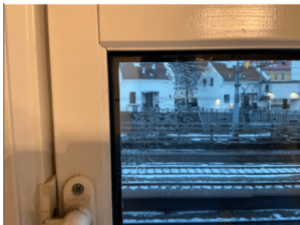
Delaminering på vindu.
