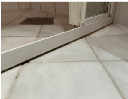
Manglende glippe under dusj dører.
