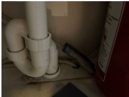
Manglende tettemuffe på kjøkkenet.
