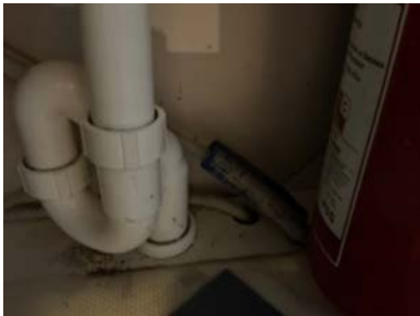
Manglende tettemuffe på kjøkken.
