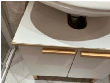
Svelling og avskallinger på innredning.
