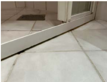
Manglende glippe under dusj dører.
