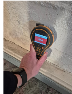
Indikert høye fuktverdier i mur og det er synlig saltutslag.
