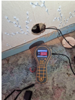
Målt høye fuktverdier i innforet vegg.
