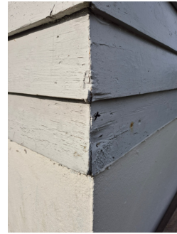
Råteskadet kledningsbord i hjørner.
