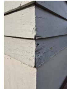
Råteskadet kledningsbord i hjørner.
