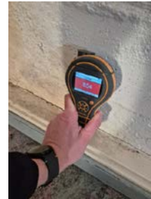
Indikert høye fuktverdier i mur og det er synlig saltutslag.
