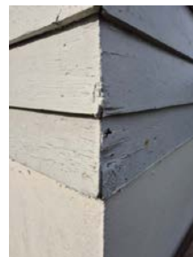
Råteskadet kledningsbord i hjørner.
