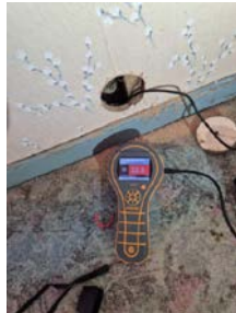
Målt høye fuktverdier i innforet vegg.
