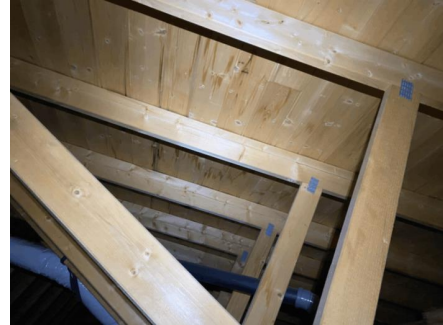
Fuktskjolder i taktro.
