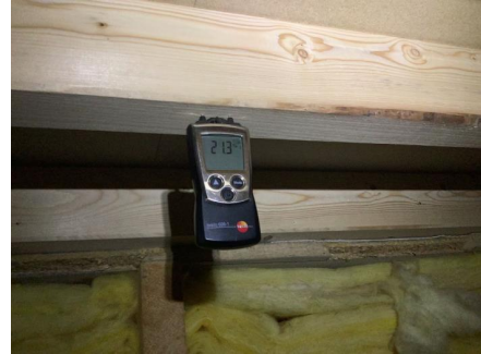
Skadelig fuktinnhold i treverk.
