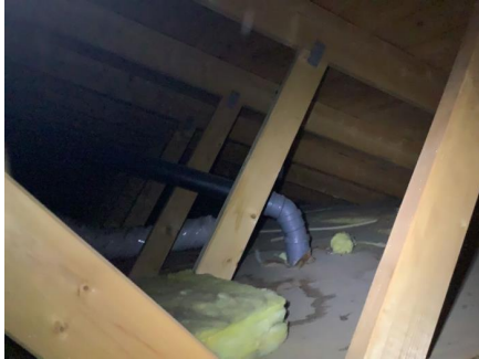
Lufterør for avløp er uisolert på loft.
