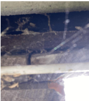
Manglende lufting bak bordkledning.
