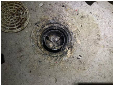
Plastsluk i grovstøpt betonggulv.
