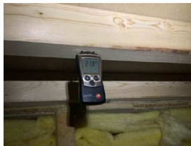
Skadelig fuktinnhold i treverk.
