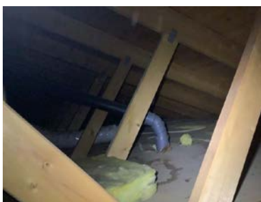
Lufterør for avløp er uisolert på loft.
