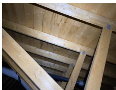
Fuktskjolder i taktro.
