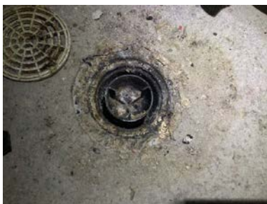
Plastsluk i grovstøpt betonggulv.
