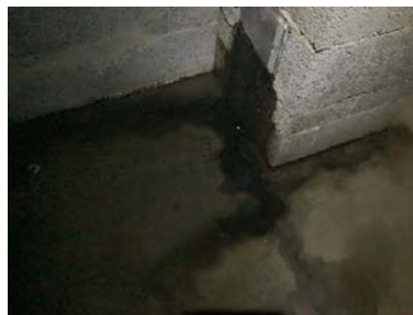
Sotvann under sotluke.
