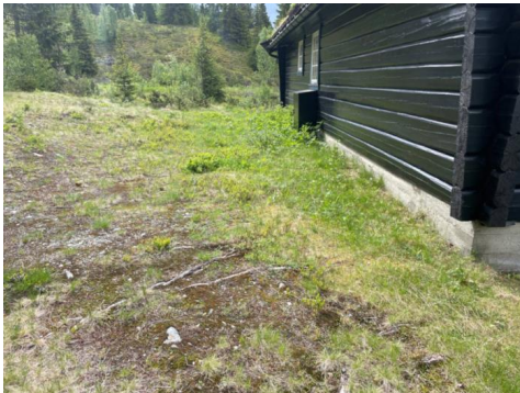
Fall til flatt terreng inn mot grunnmur
