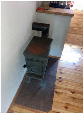
Røykrør for nærmere benkeplate
