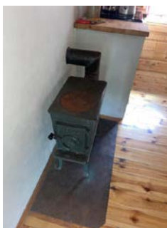
Røykrør for nærme benkeplate
