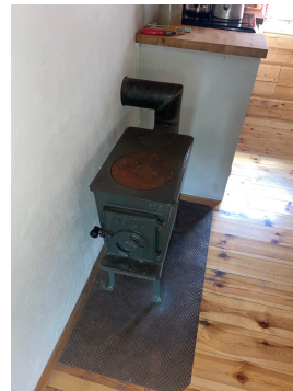
Røykrør for nærme benkeplate
