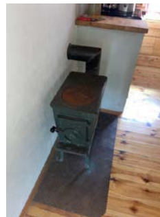
Røykrør for nærme benkeplate
