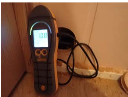
Fuktmålinger i nedre del av vegg på soverom viser kun moderate fuktverdier i bunnsvill.
