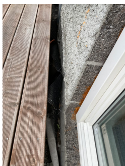
Manglende topplst på fuktsikring
