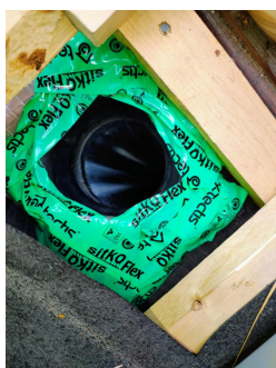
Selger har etablert teip/ tett på avløsrør fra utsiden.
