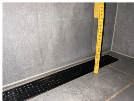
Høydeforskjell på 40mm fra topp flis ved dør til topp flis ved sluk.
