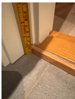
Synlig membran ved dørterksel
