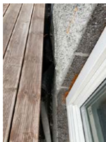
Manglende topplist på fuktsikring
