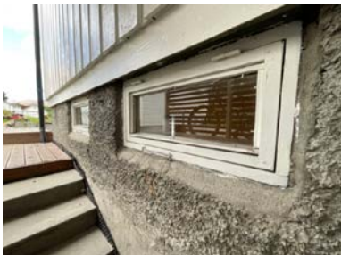
Manglende toppliste på fuktsikring over bakkeplan.
