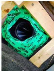
Selger har etablert teip/ tett på avlørør fra utsiden.
