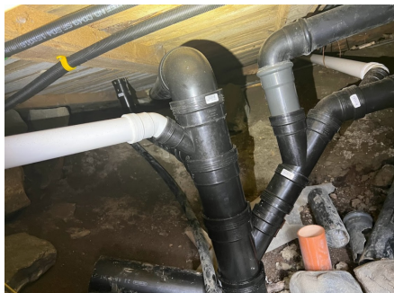
Avløpsrør i krypkjeller
