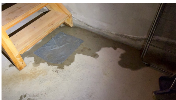
Vanninnsig ved trapp i kjeller.
