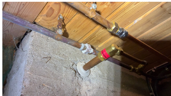
Det drypper fra rørskjøt i kjeller.
