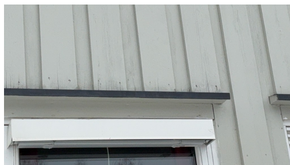
Eksempel på oppsprekking i kledning.
