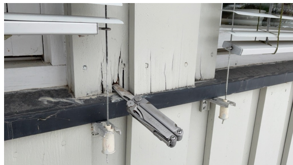
Råte i kledning rundt vindu
