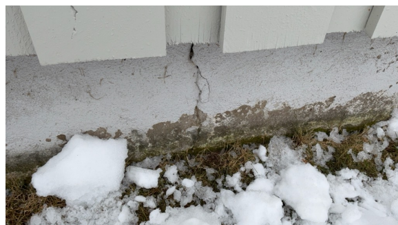
Eksempel på sprekk i grunnmur.
