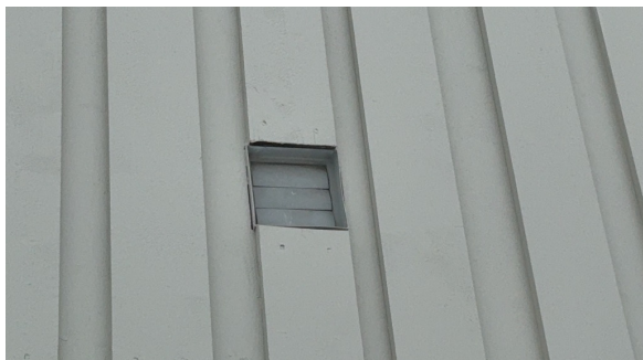
Utett løsning rundt veggventil.
