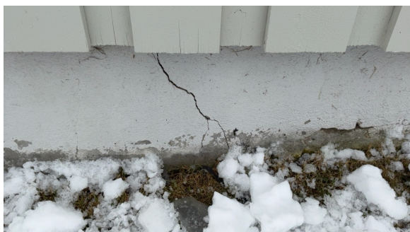
Eksempel på sprekk i grunnmur.
