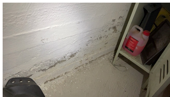
Eksempel på avskaling av maling.
