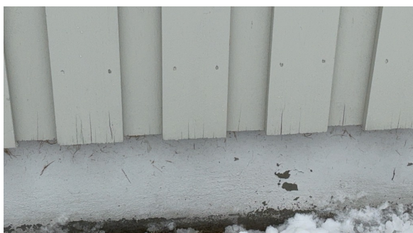
Eksempel på oppsprekking i kledning.
