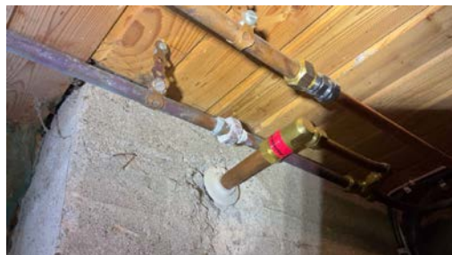
Det drypper fra rørskjøt i kjeller.
