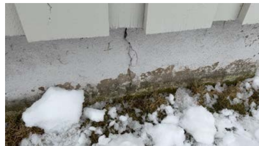
Eksempel på sprekk i grunnmur.
