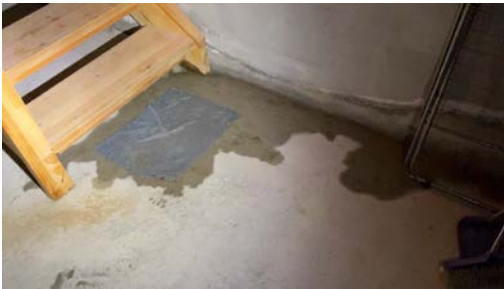
Vanninnsig ved trapp i kjeller.
