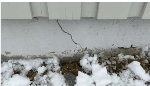
Eksempel på sprekk i grunnmur.
