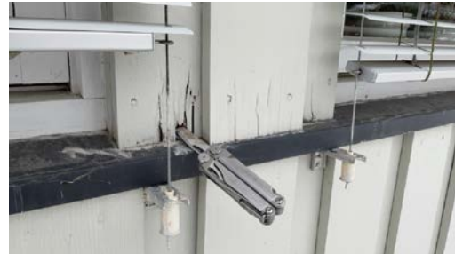
Råte i kledning rundt vindu
