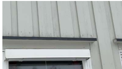
Eksempel på oppsprekking i kledning.
