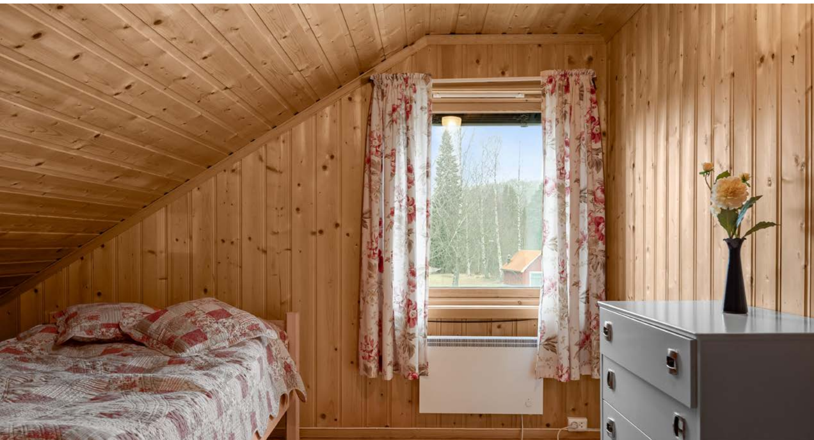
Oppvarming med panelovn.
