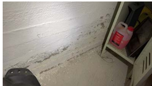
Eksempel på avskaling av maling.
