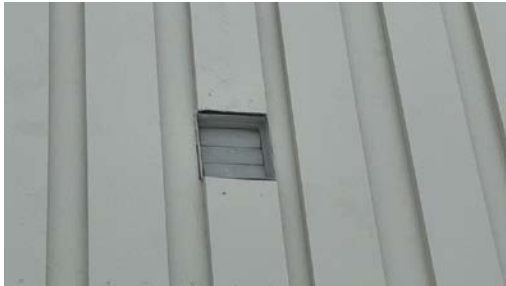
Utett løsning rundt veggventil.
