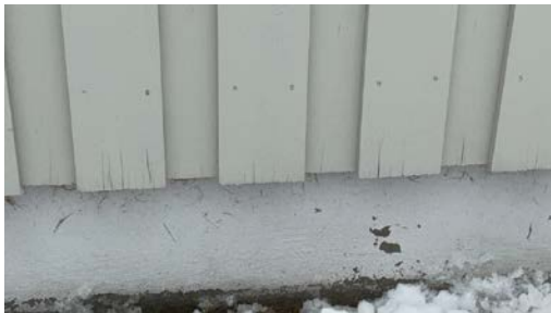
Eksempel på oppsprekking i kledning.
