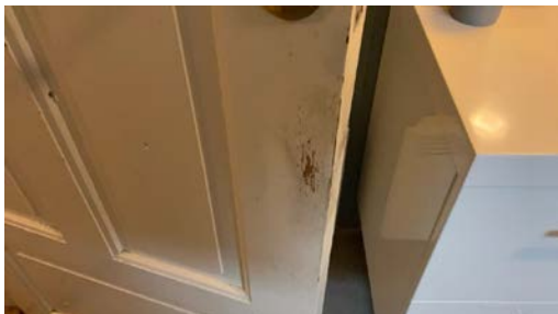
Eksempel på slitasje.
