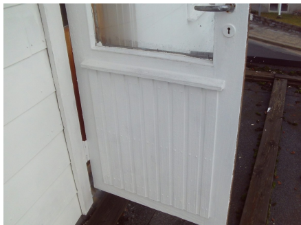
Eldre slitt ytterdør på loftet
