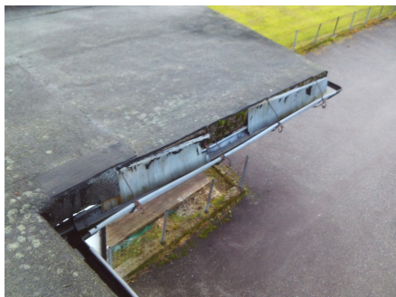
Eldre slitte takrenner og skvettzink.
