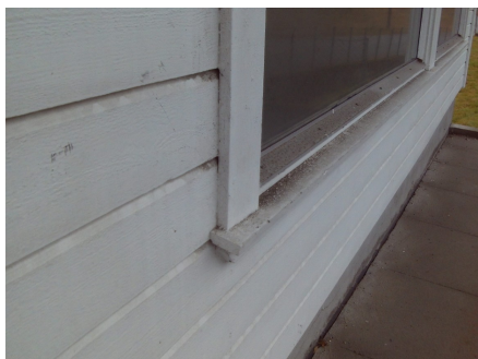
Normal slitasje på store vinduer utvendig
