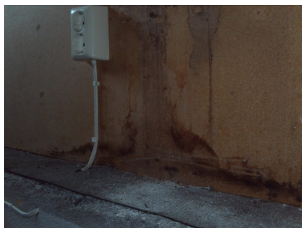
Skader ved vindu og vegg trapperom.
