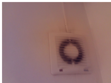
Vifte for ventilasjon av rommet.
