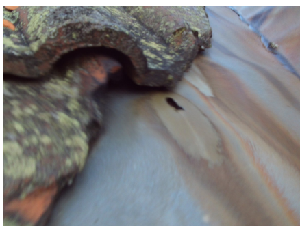
Slitt bly i gradrenne på opprinnlig del med noen hu
