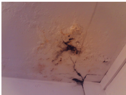
Skade i betonghimling frisørsalong
