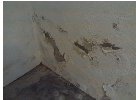
Fuktvandring i opprinnelig grunnmur.
