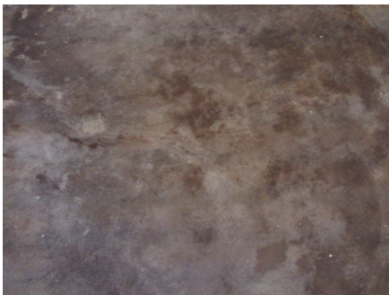
Fuktvandring i støpt gulv.
