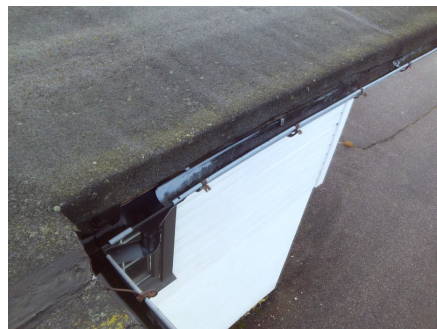
Deler av takrenner på eldste deler.
