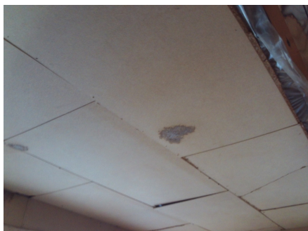
Skader i himlig trapperom.
