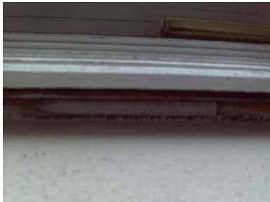
Noe lite tilgang på luft enkelte steder bak kledningen.
