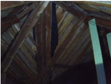
Misfarget undertak (kondensmerker)
