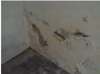
Fuktvandring i opprinnelig grunnmur.
