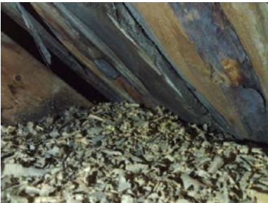
Ingen tilgang på luft
