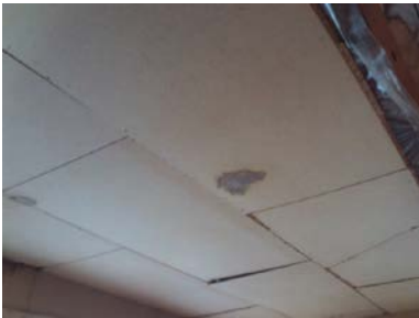
Skader i himlig trapperom.
