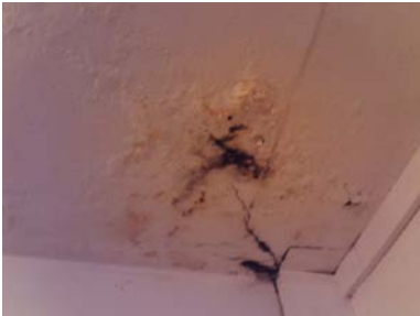
Skade i betonghimling frisørsalong
