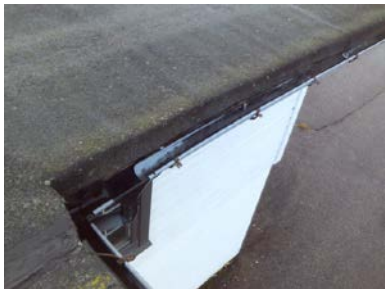
Deler av takrenner på eldste deler.
