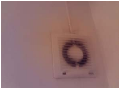
Vifte for ventilasjon av rommet.
