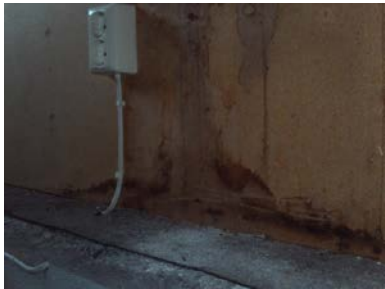
Skader ved vindu og vegg trapperom.
