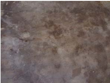
Fuktvandring i støpt gulv.
