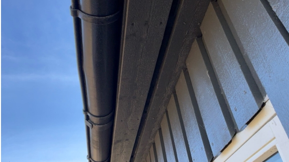
Synlig luftespalte i gesims.
