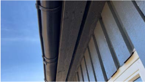
Synlig luftespalte i gesims.
