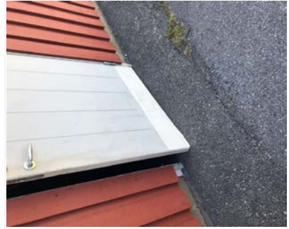
Dør som subber mot terreng
