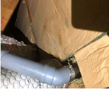
Fuktskjolder på isolasjon. Antatt fra kondens
