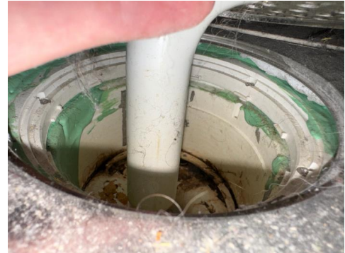
Sluk under dusjkabinett
